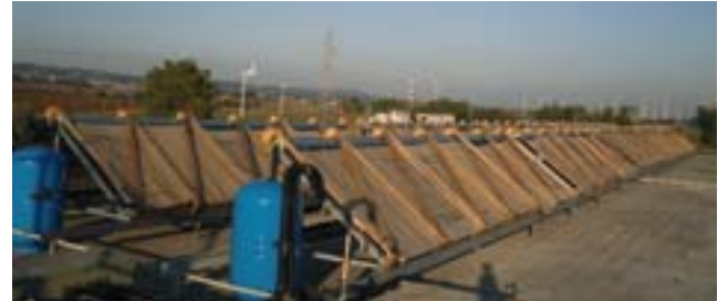
Un impianto solare termico
